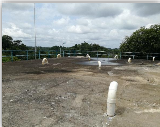
Fotografía: Tanque de almacenamiento
