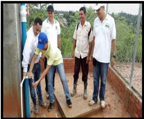
Suministro de agua potable
